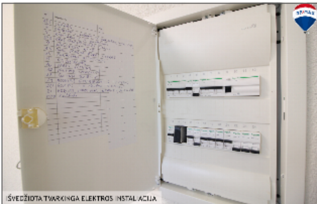
ĮŠVEDŽIOTA TVARKINGA ELEKTROS INSTALACIJA
